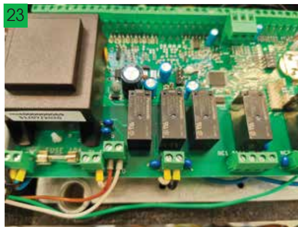
Collegare il cavo bianco e marrone rispettivamente ai morsetti L0 e LC e richiudere la macchina | Connect the white and brown cable respectively to terminals L0 and LC and close the machine again
